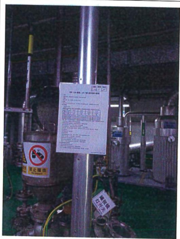
2#厂房引发剂罐加料口
