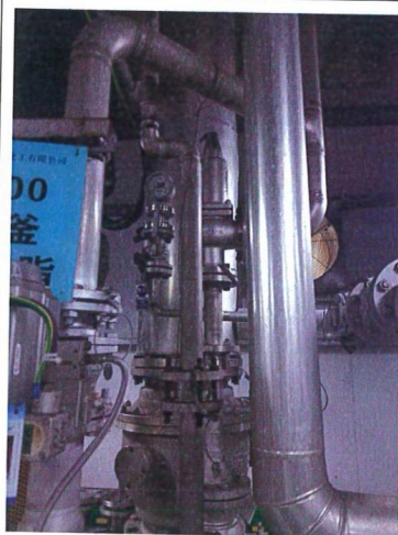
聚合釜泄压设施（安全阀+爆破片）
