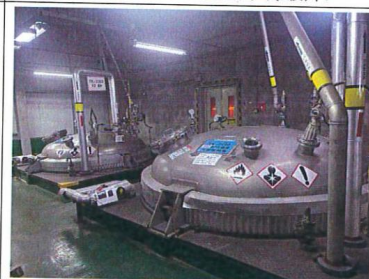
2#厂房丙烯酸树脂储罐
