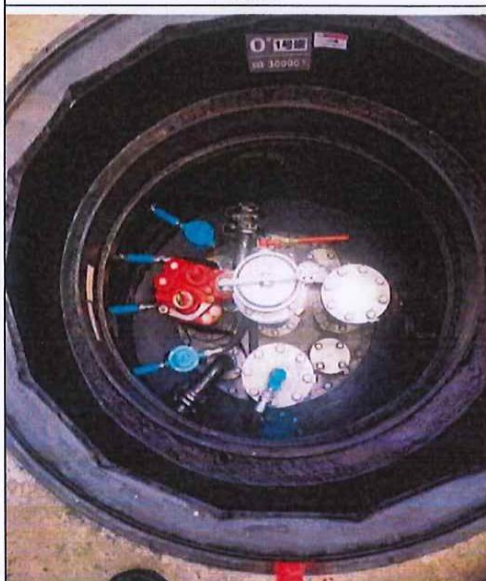
柴油罐操作井
