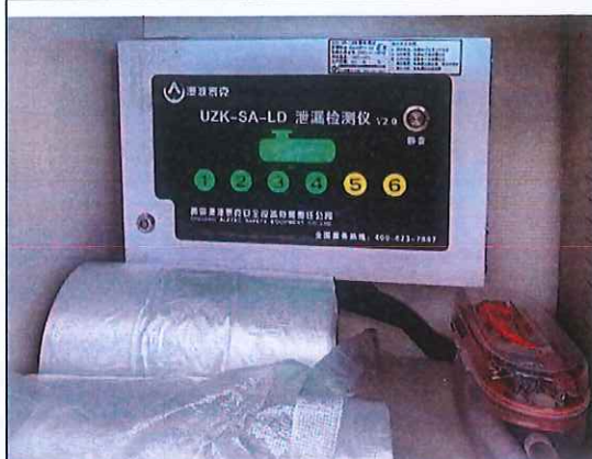
储罐渗漏监测
