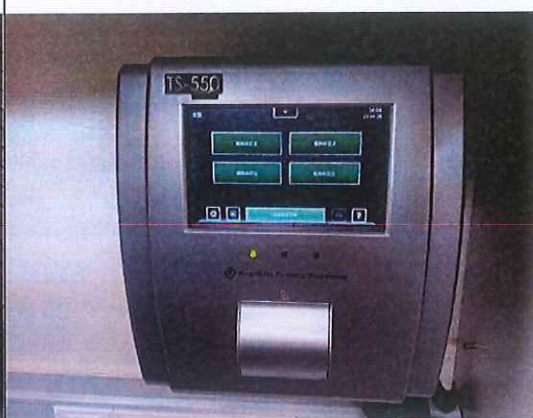
双层油管渗漏监测
