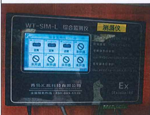
在线渗漏监测系统
