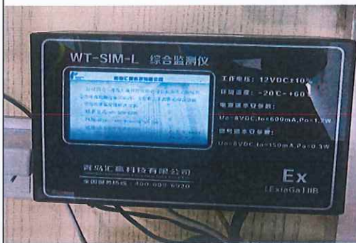
在线渗漏监测系统
