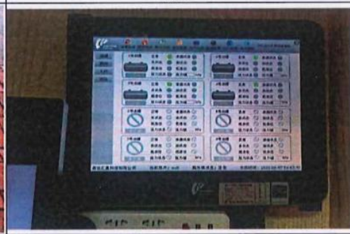
油罐和油管在线渗漏监测系统
