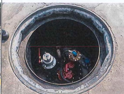
汽油罐操作井
