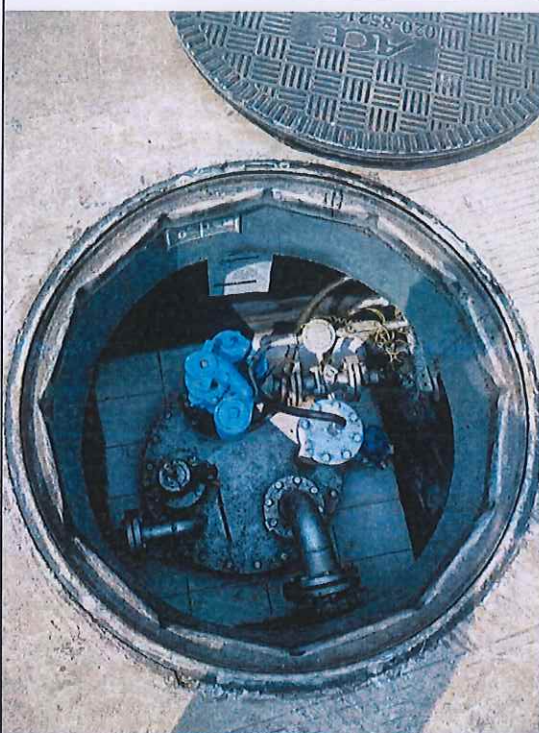
柴油罐操作井
