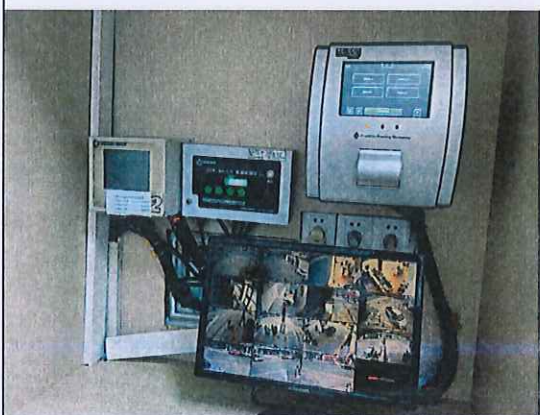
油罐在线渗漏监测系统、液位计、视频监控
