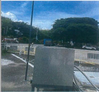
三次油气回收装置
