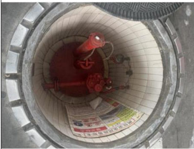
汽油罐操作井
