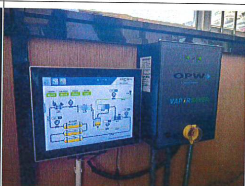
储油油气回收监测系统
