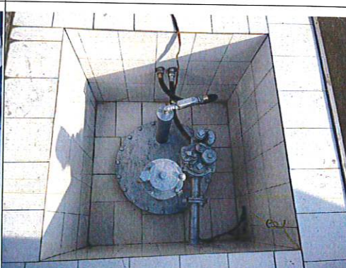
柴油储罐操作井
