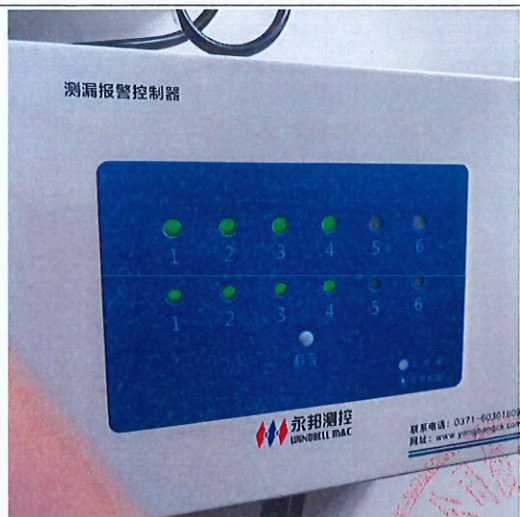
双层油罐--双层油管渗漏监测系统
