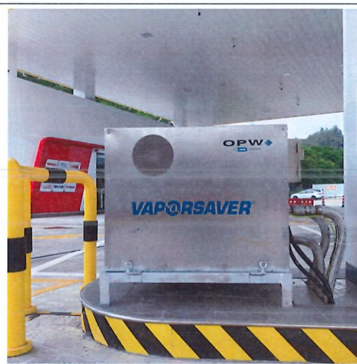
三次油气回收装置
