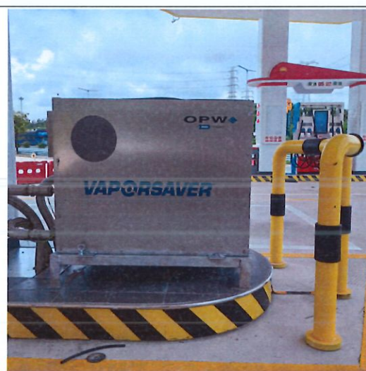
三次油气回收装置
