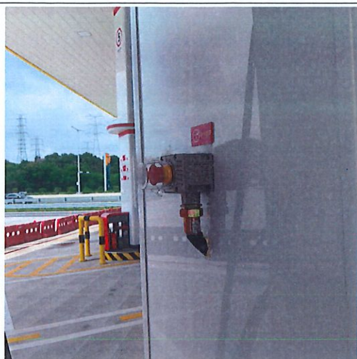
加油区总紧急切断按钮
