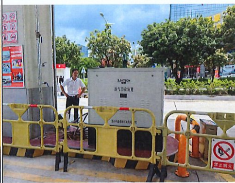
三次油气回收装置
