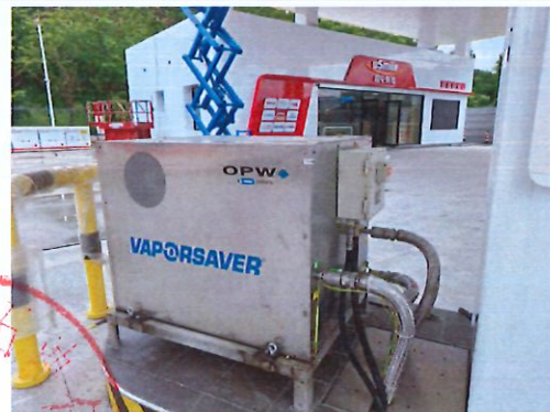
三次油气回收处理装置
