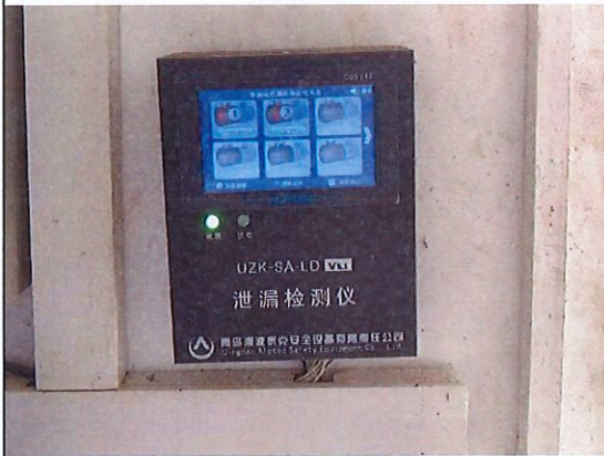
油罐在线泄漏监测系统
