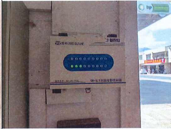
双层管道在线泄漏监测系统
