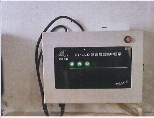
油罐在线渗漏监测系统
