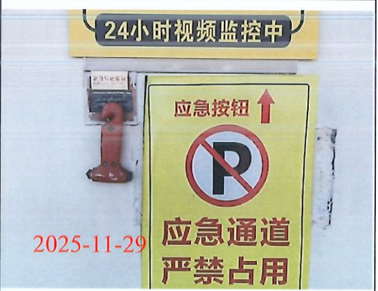
站房外墙紧急按钮
