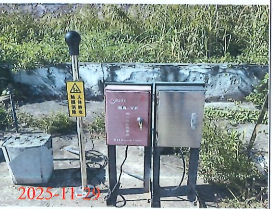
静电接地装置及人体静电消除器
