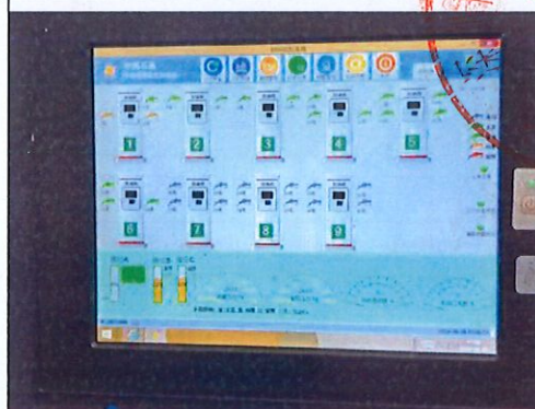
二次油气回收系统显示屏
