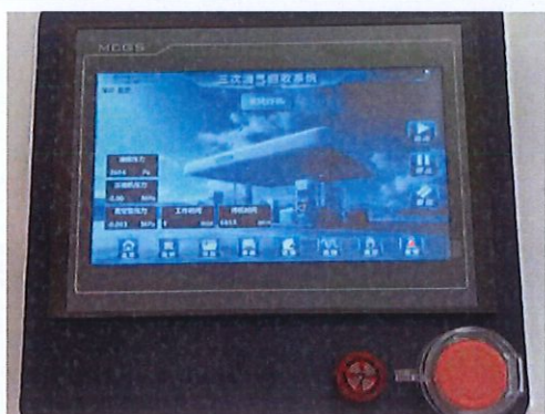
三次油气回收系统显示屏
