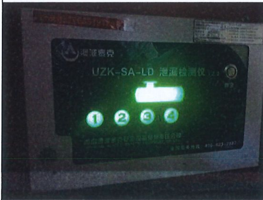
储罐渗漏在线监测
