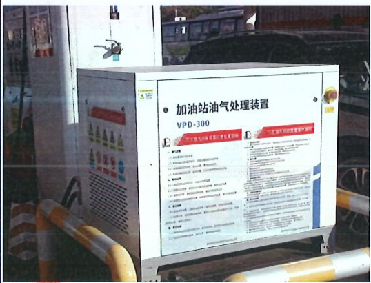
三次油气回收处理装置
