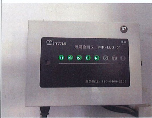
油罐—双层管道在线渗漏监测系统
