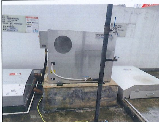
三次油气回收装置
