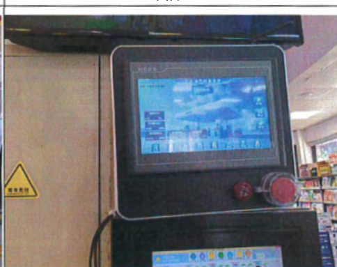
三次油气回收系统显示屏
