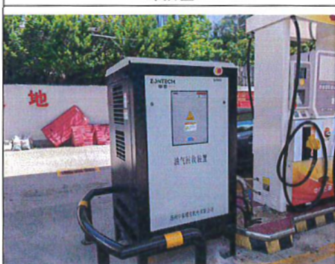
三次油气回收装置
