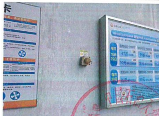
外墙紧急切断按钮
