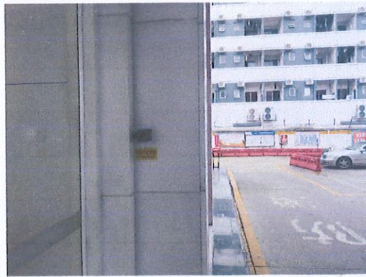
站房外墙紧急按钮
