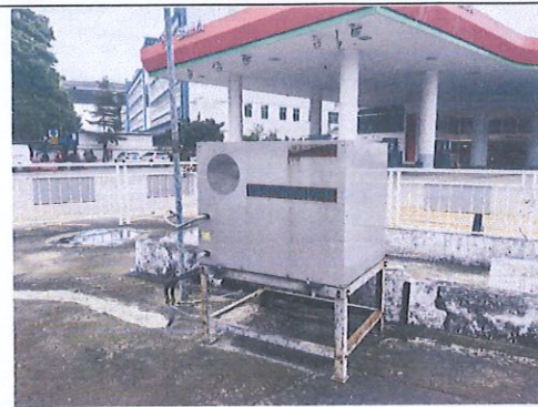
三次油气回收装置
