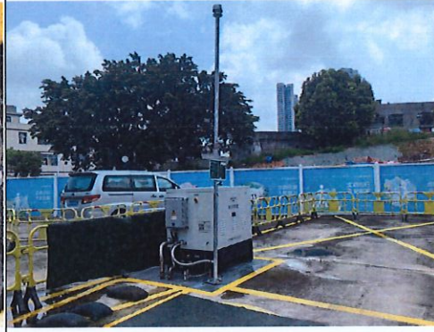
三次油气回收装置
