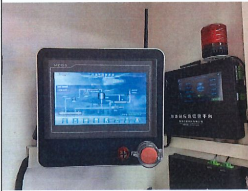
三次油气回收系统显示屏
