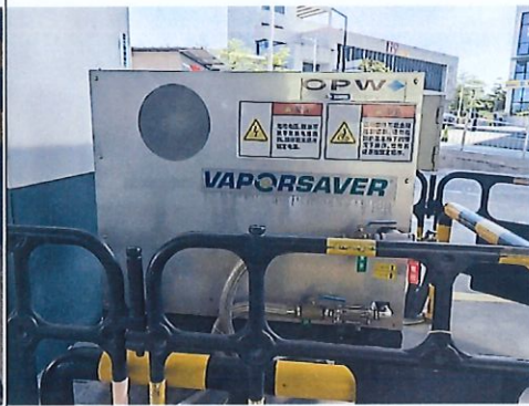
三次油气回收装置
