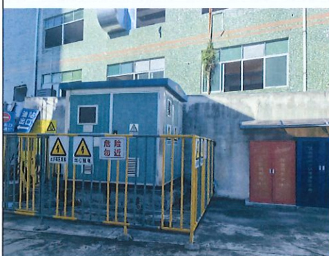
站内箱式变压器
