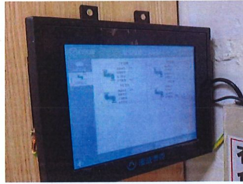
双层管道在线渗漏监测
