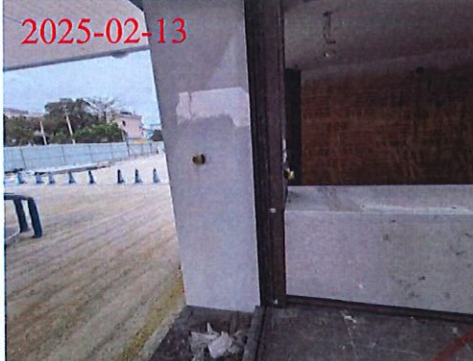
站房内及站房外紧急按钮
