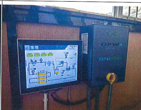
储油油气回收监测系统
