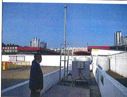
三次油气回收装置
