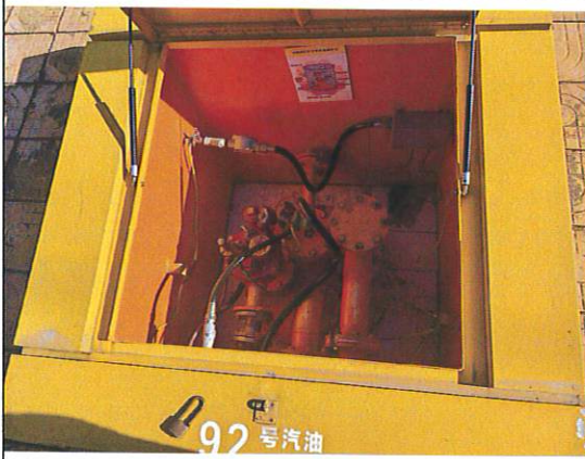
汽油储罐操作井
