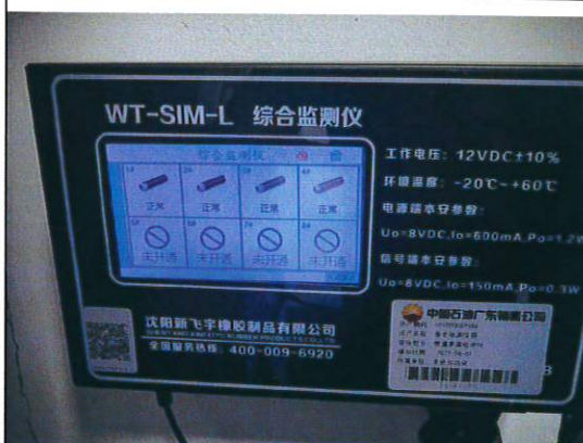
油管在线渗漏监测系统
