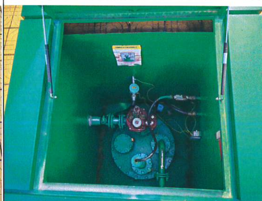
柴油储罐操作井
