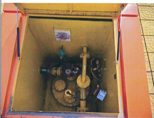
汽油储罐操作井
