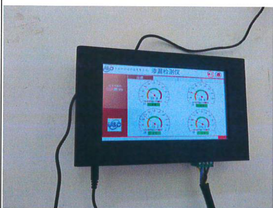
油罐在线渗漏监测系统
