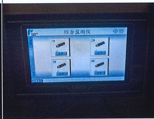
双层管道在线渗漏监测
