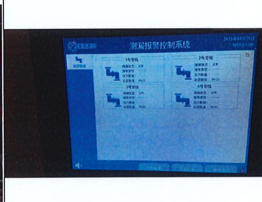
双层管道在线渗漏监测
