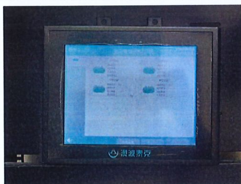
双层油罐在线泄漏监测系统
