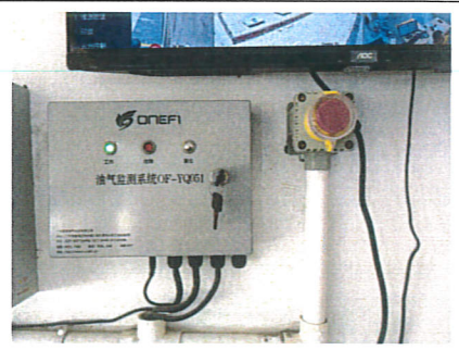
双层油罐双层油管在线渗漏监测系统 站房内紧急按钮
