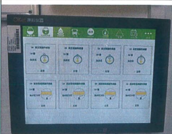
双层储罐双层油管渗漏在线监测
