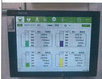
储罐液位监测
