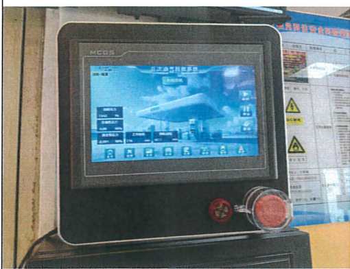
三次油气回收系统显示屏
