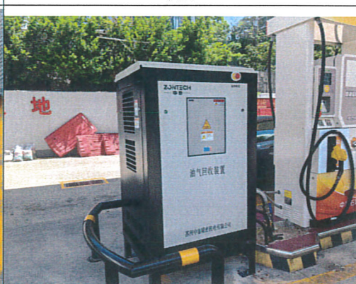
三次油气回收装置
