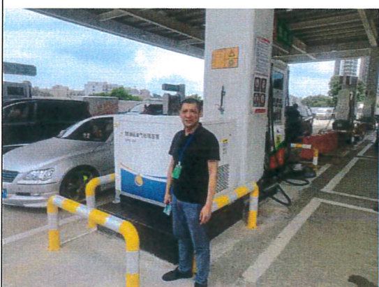
三次油气回收装置
