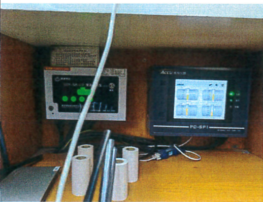
储罐渗漏在线监测、液位仪
