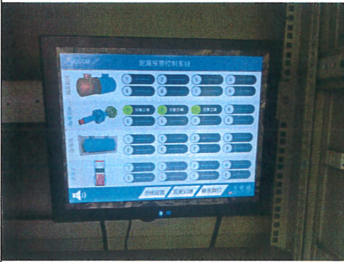
双层管道在线渗漏监测系统
