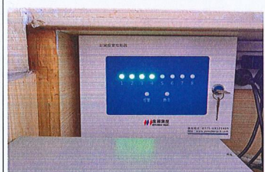
油罐—管道在线渗漏监测系统
