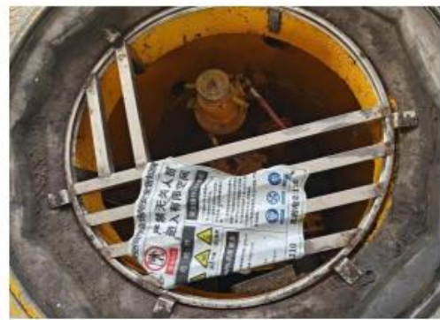
汽油储罐人孔井
