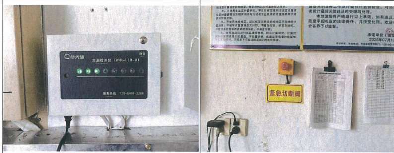
油罐—油管在线泄漏监测系统
