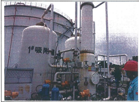
油气回收处理装置
