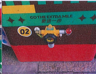
加油区可燃气体检测报警装置
