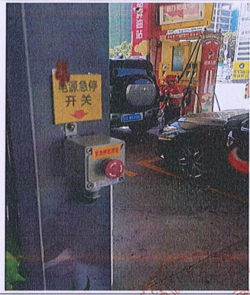
站房外墙紧急按钮
