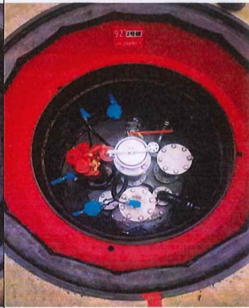
汽油罐操作井
