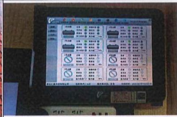
油罐和油管在线渗漏监测系统
