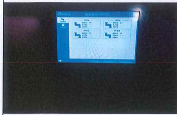
油管在线渗漏监测
