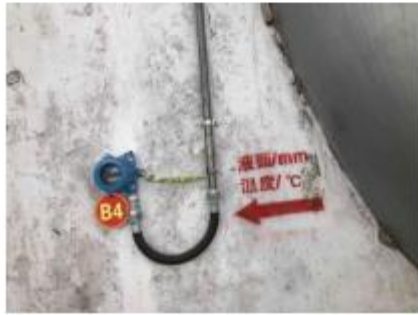
储罐就地显示温度计液位
